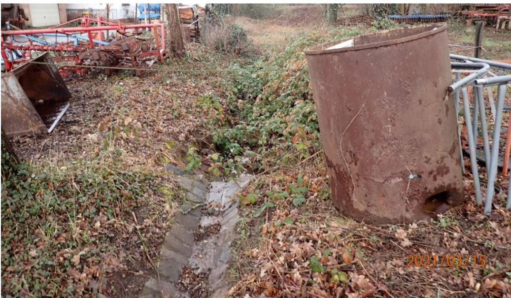
Abb. 79: Rinne zur Ableitung von Oberflächenwasser der Straße
