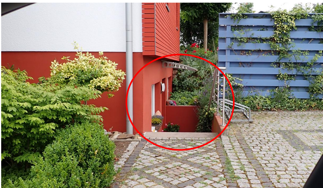
Abb. 31: Beispiele für überflutungsgefährdete Bauweise
