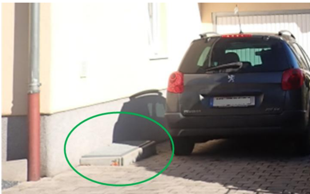
Abb. 17: Beispiele für die Sicherung eines niveaugleichen Lichtschachtes
