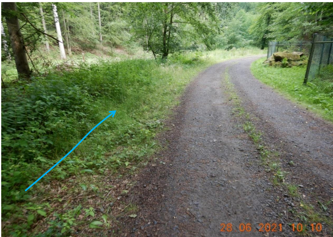
Abb. 55: Wiederherzustellender Wegseitengraben zur natürlichen Senke
