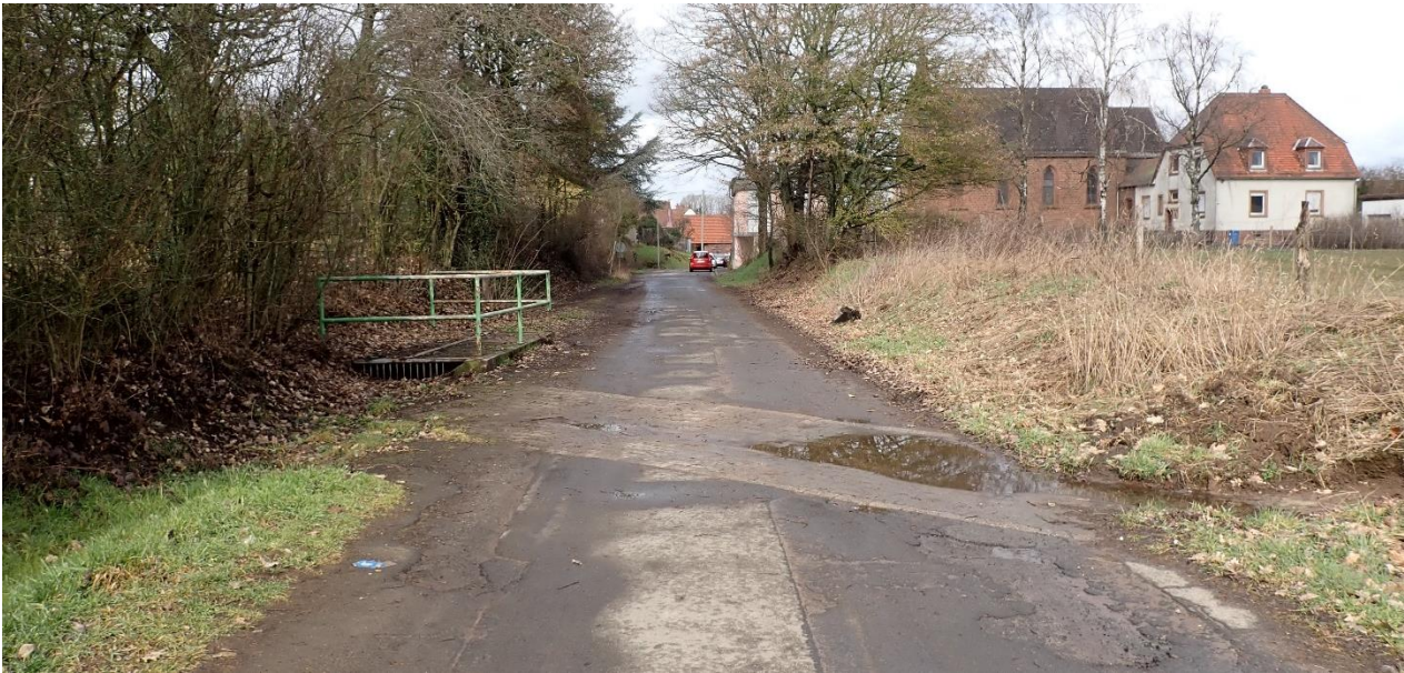
Abb. 40: Querrinne und Sandfang in der Fischbacher Straße
