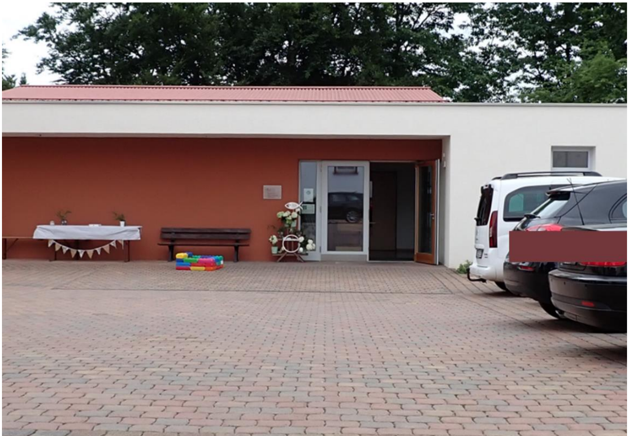
Abb. 21: Überflutungsgefährdetes Gebäude mit niveaugleicher Eingangstür an abschüssigem Hof
