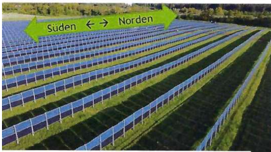
Fig. 2: Agri-PV mit vertikalen Modulen
